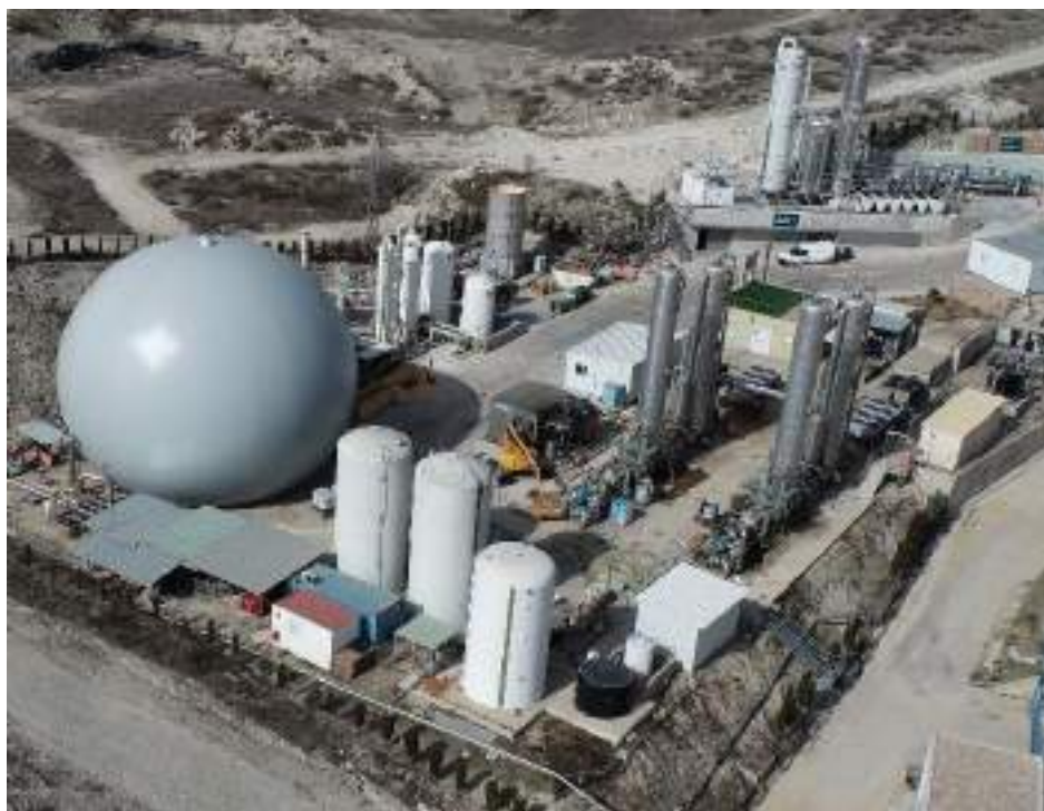
Vista aérea de la planta de tratamiento de biogás
