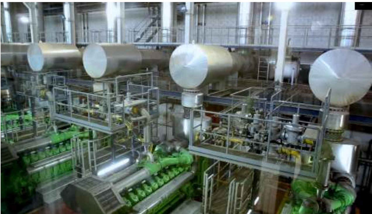
Sala de motores en La Galiana
