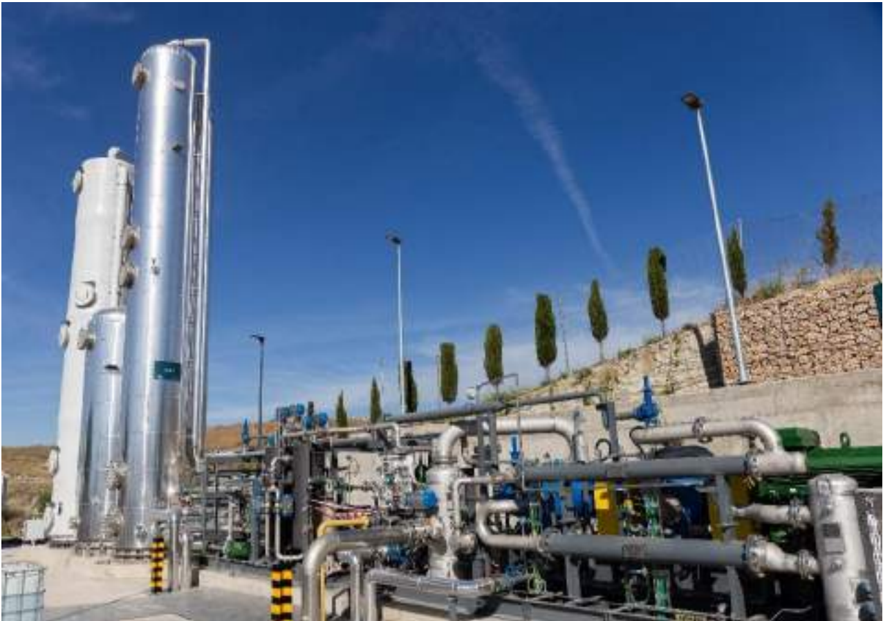
Nueva línea de upgrading en la planta de tratamiento de biogás
