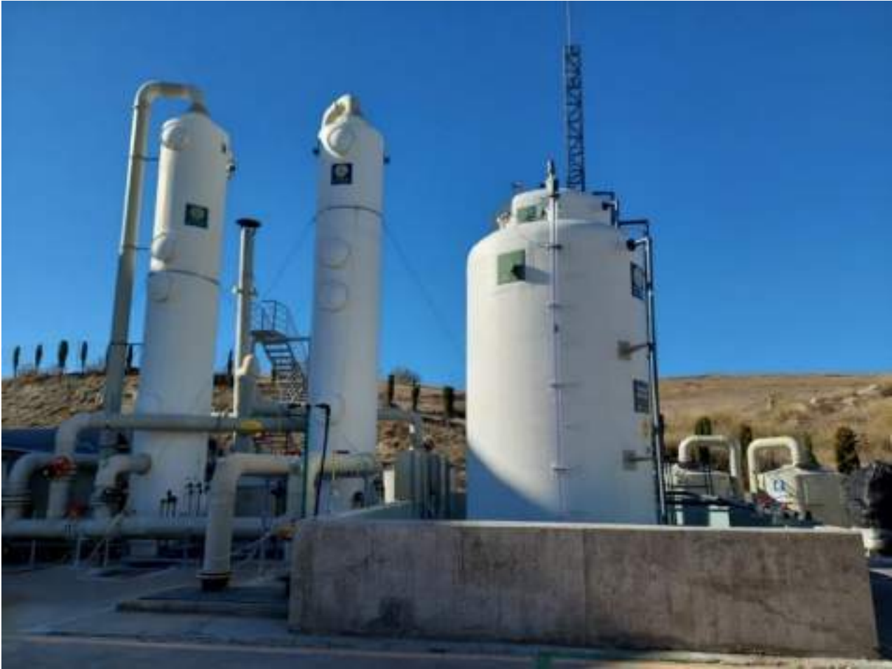
Sistema de depuración de gases de la planta de tratamiento de biogás
