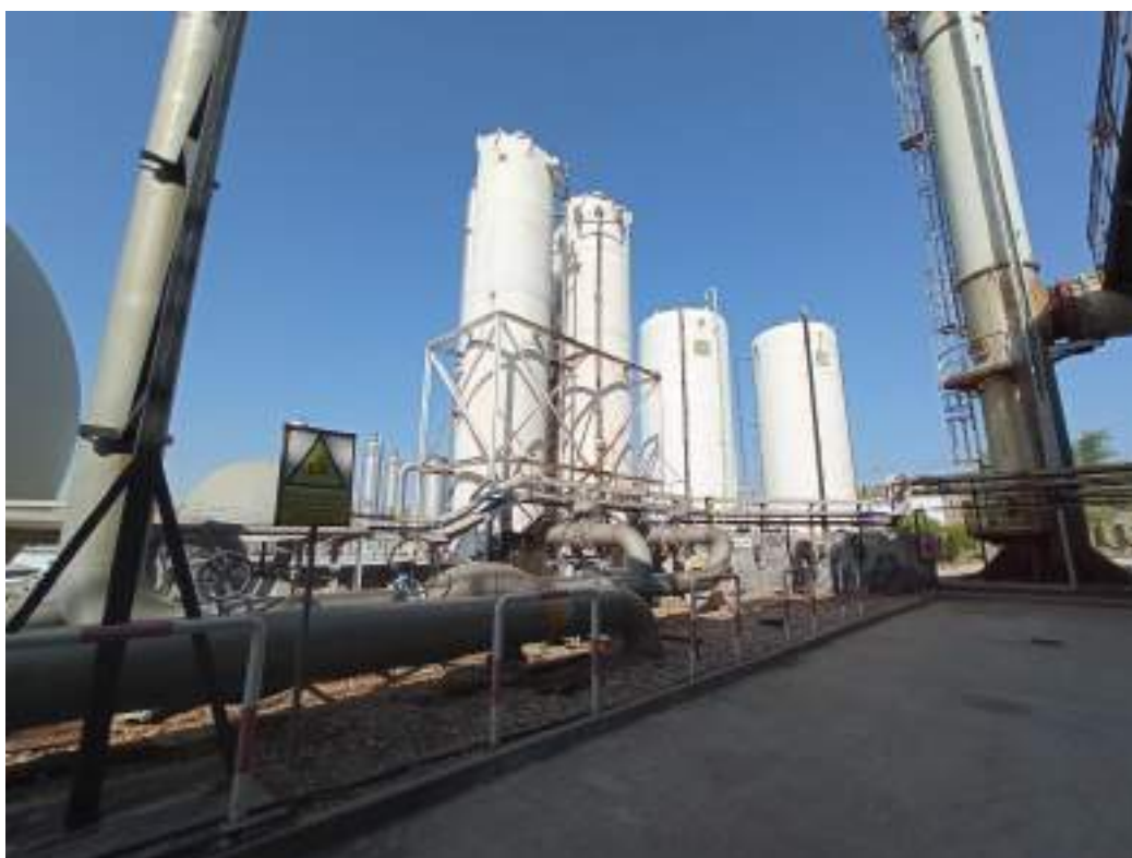
Tratamiento de biogás en La Galiana
