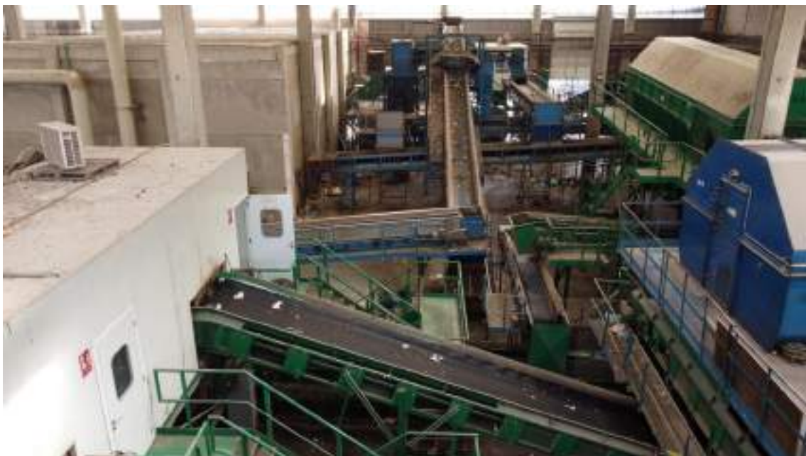
Cintas de pretratamiento de la planta de biometanización de Las Dehesas
