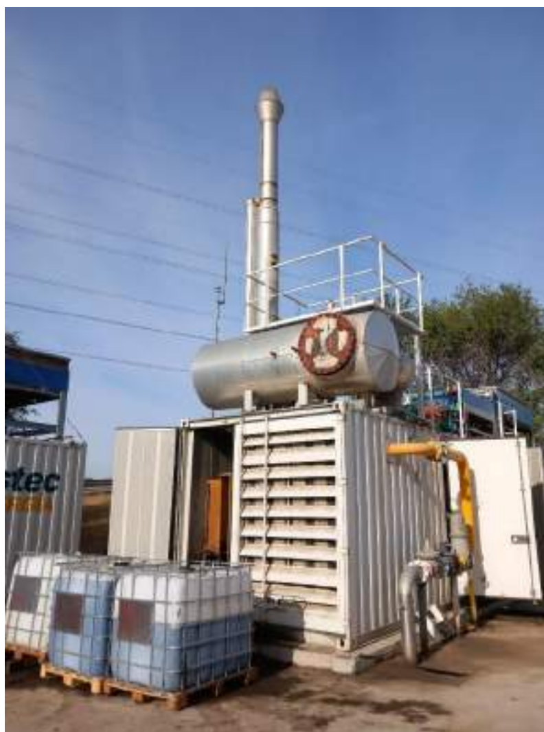
Motogenerador de Las Dehesas
